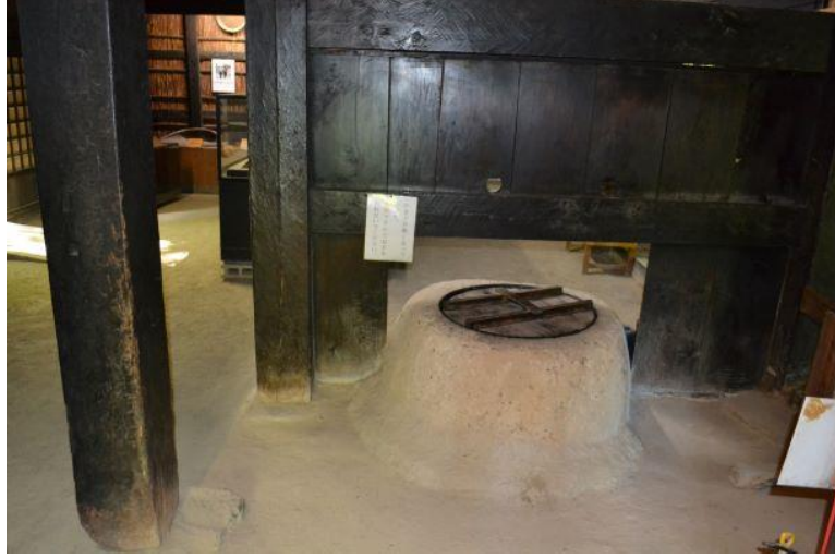
Resim 19 Ahşap sütunların toprak zemin ile temas noktalarına sütun taşı yerleştirilmiştir.
